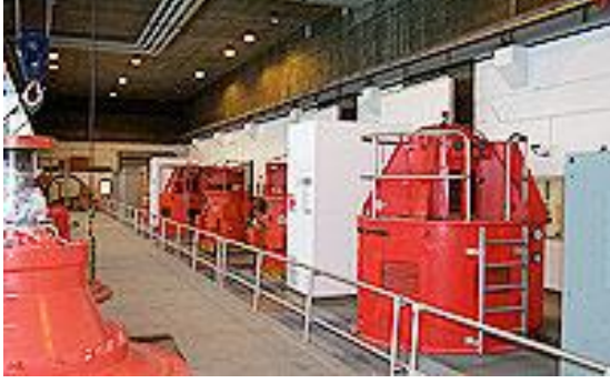
Pompa İstasyonu Boru Hatları
