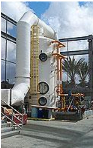
Koku Kontrol Yıkayıcıları (: Scrubbers) Fotoğrafi
