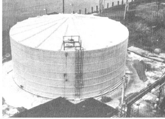
Figür3- Hidroklorik asit tankı
